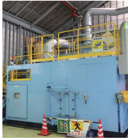
紙おむつの乾燥に化石燃料を使わず、ごみ焼却場の余熱を利用する 「使用済み紙おむつ燃料化実証施設」
