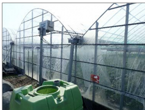
防犯カメラの設置
