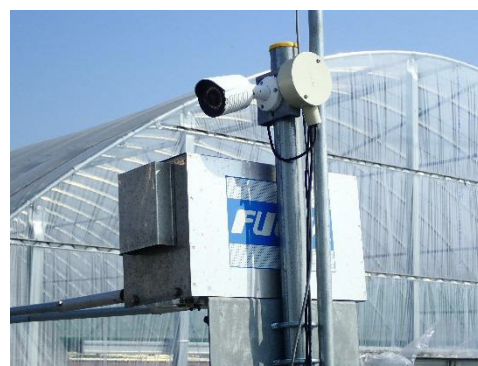
防犯カメラの設置
