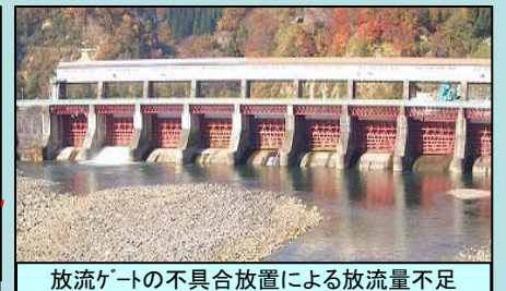
放流ゲートの不具合放置による放流量不足
