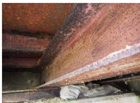
鋼桁の腐食等
