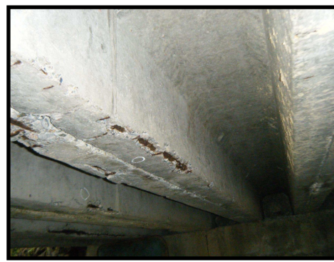
鉄筋露出・コンクリート剥落
