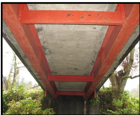
鋼部材の腐食
