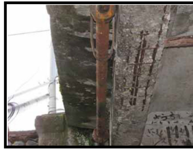
鉄筋露出・コンクリート剥落
