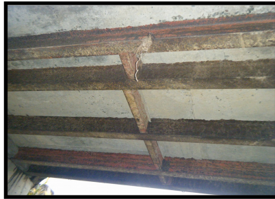
鋼部材の腐食
