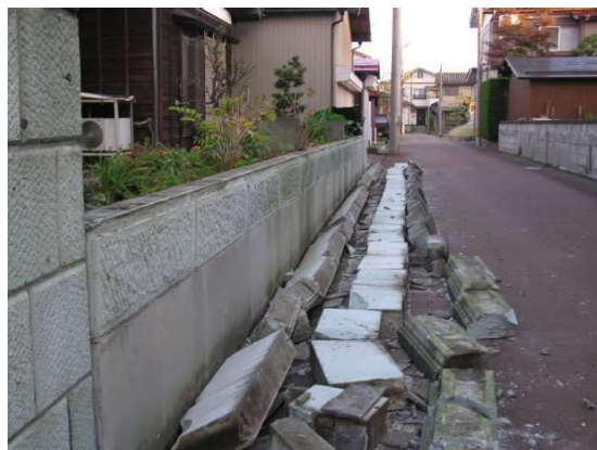
[倒壊したブロック塀の様子]
