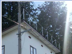
雪庇防止フェンスを兼ねる
