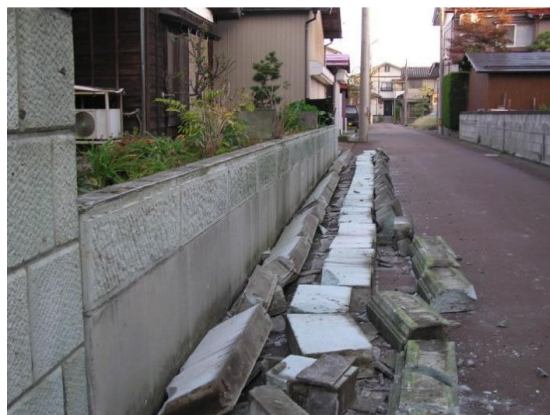
[倒壊したブロック塀の様子]
