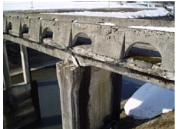
幅員が狭く、老朽化した放水路の橋
