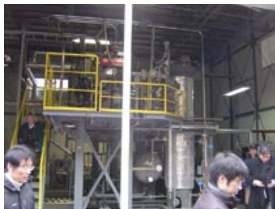
松之山温泉バイナリー発電実証試験設備
