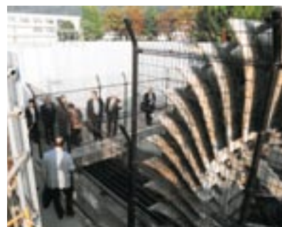
市役所前に設置された小水力発電施設「元気くん1号」
