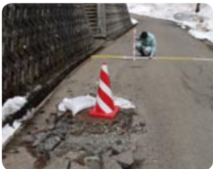
市道栃倉線（松之山）の陥没現場
