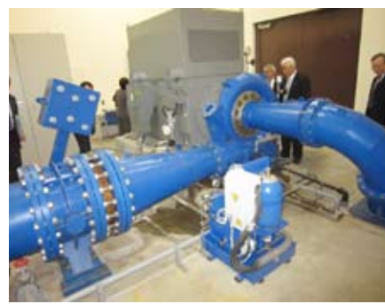
山梨県北杜市の小水力発電施設
