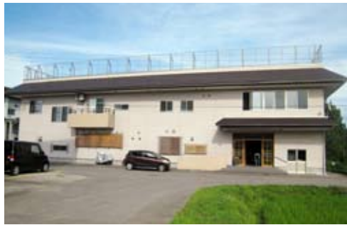
雪の重みで屋根折板の一部が変形した川西「千寿さくら荘」
