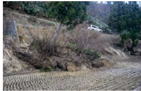
春の雪解け水で用水路の法面が崩落した現場（小出地内）
