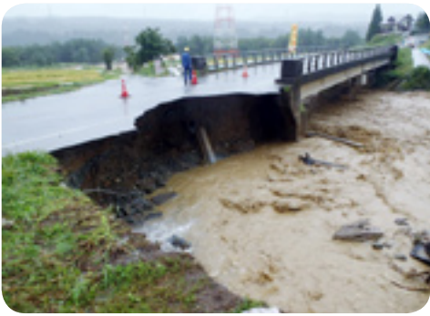
台風18号により崩落した新羽根川橋付近
