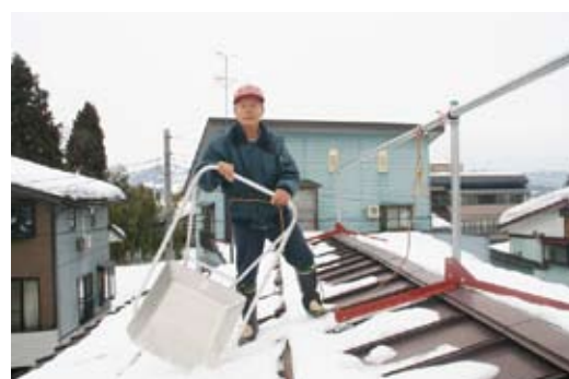
安全雪おろし命綱屋根アンカー（十日町新聞社提供）
