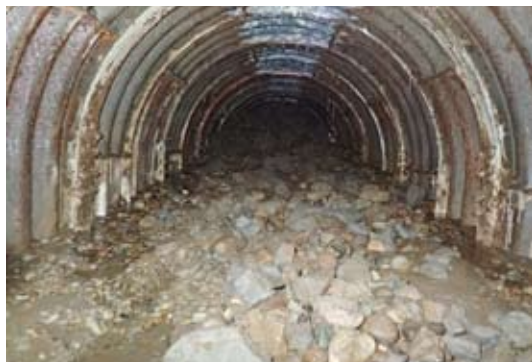
崩落土砂が堆積した水路トンネル
