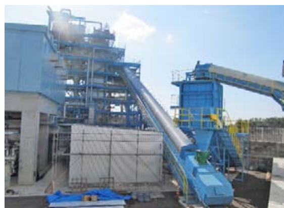
年間4,550万kWを発電する(株)宮崎森林発電所
