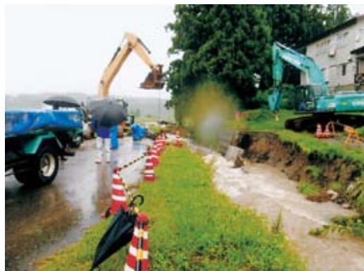
梅鉢川災害状況（下条地区桑原地内）
