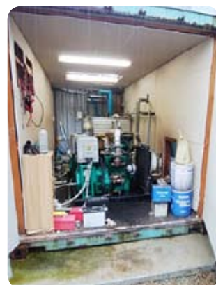
メタンガス発電設備
