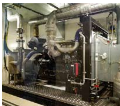
木質ペレットを燃料とした 発電ボイラー
