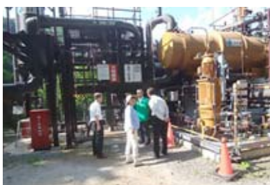
土湯温泉の地熱発電
