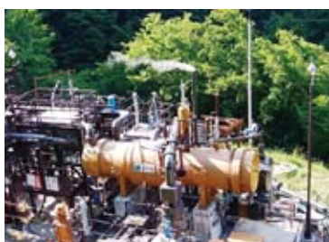
温泉熱を利用したバイナリー発電所
