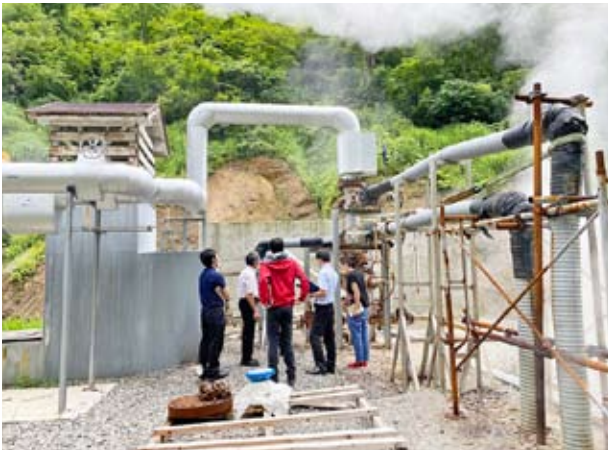
地熱バイナリー発電所（松之山）
