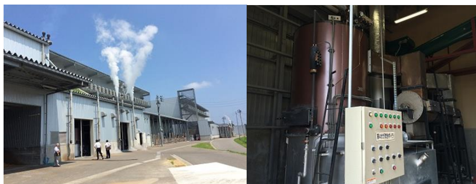
松之山なめこ工場（きのこ廃菌床を燃料利用しているボイラー）
