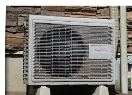
空気熱源ヒートポンプ
