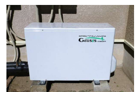
地中熱ヒートポンプ
