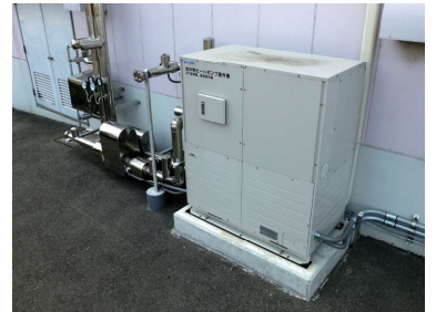
地中熱ヒートポンプ（室外機）
