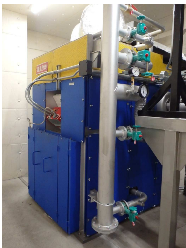
② バイオマスボイラー
