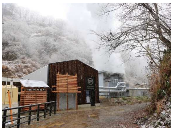
松之山バイナリー発電所
