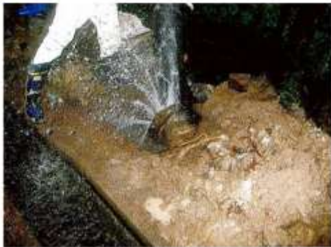
水道管の被害の例
