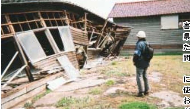
全壊した古い工場（輪島市門前町）
