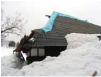
松之山郷民俗資料館屋根が大きく破損しました (1月12日(木))
