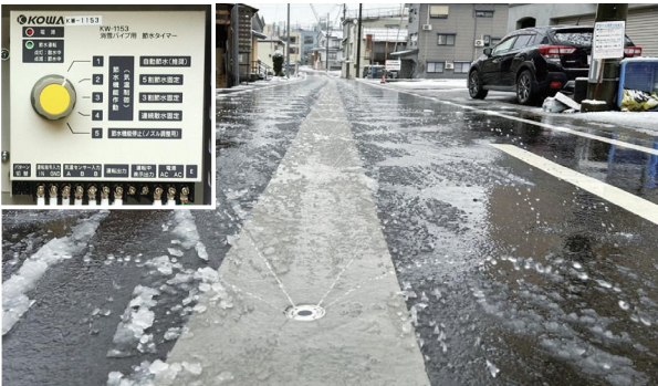
消雪パイプと節水タイマー
