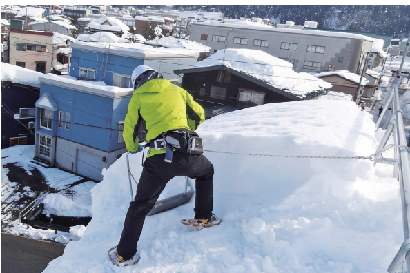
命綱固定アンカー
