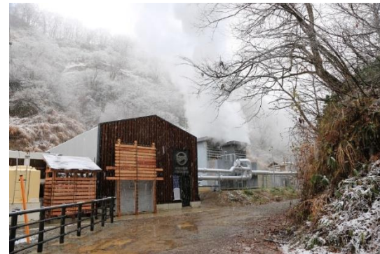
松之山温泉地熱バイナリー発電所
