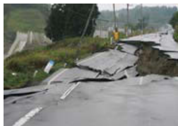
国道252号の被害（川西地域）
