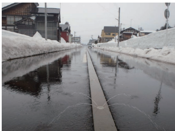
地下水利用の消雪パイプ
