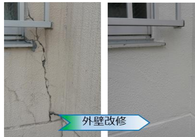
<谷内丑住宅 外壁劣化部>
