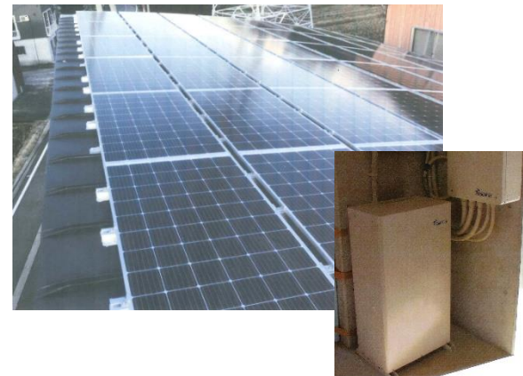
融雪機能付き太陽光パネル・蓄電池
