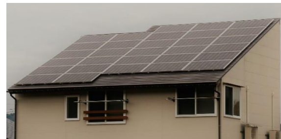
太陽光発電設備
