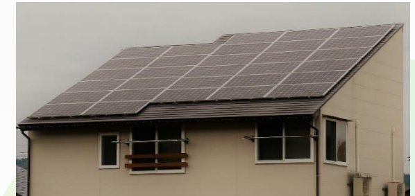
太陽光発電設備
