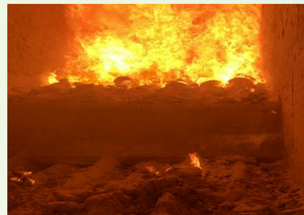
ごみ焼却炉内部 燃焼状況
