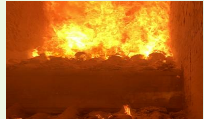
ごみ焼却炉内部 燃焼状況
