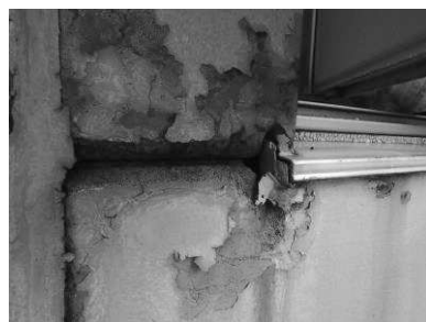
<外壁劣化状況>
