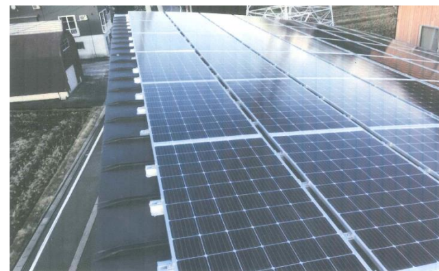
融雪機能付き太陽光パネル
