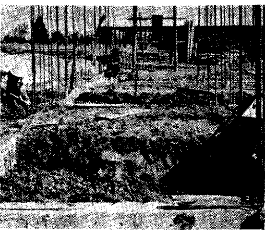
川西平野のまん中に、建設のツチ音が高らかにひびく。鉄筋三階の校舎建設が進んでいる。それは、町の未来を告げる音でもあるかのようだ。 川西中学校の建築現場で 撮影 北村 準一
