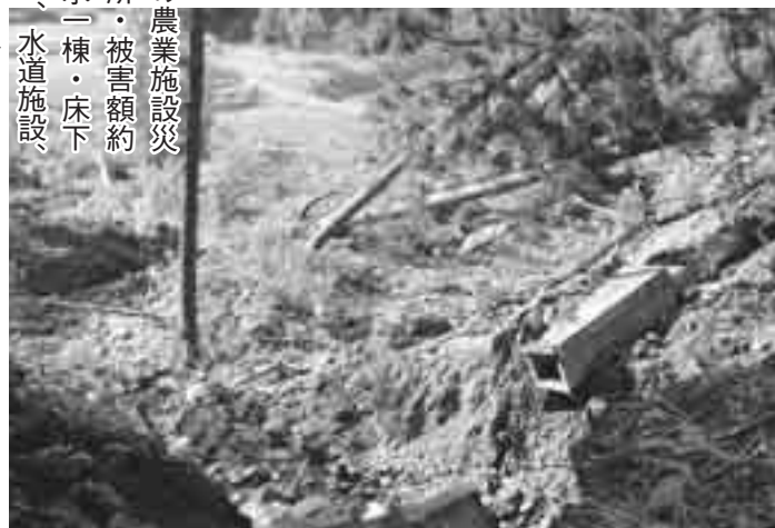
山林、道路、水路ともに崩落した斜面（原田地内）
