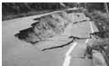
地震で大きく陥没した国道252号
