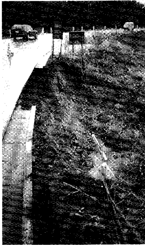
【珠川地内】 広域農道。路肩が決壊しガードロープも滑り落ちる。
